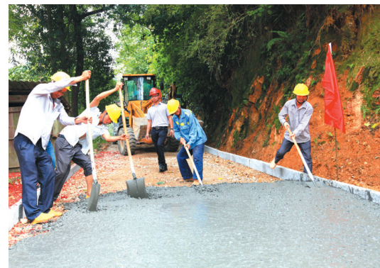
▲工人在新安村盘马屯至林科所的屯级路上整理混凝土面层。
