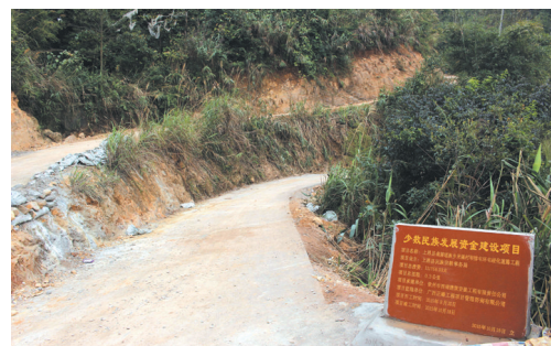
▲少数民族群众拍手称快的“民心工程”——上思县南屏瑶族乡米强村琴排屯屯屯硬化道路工程圆满落成。
