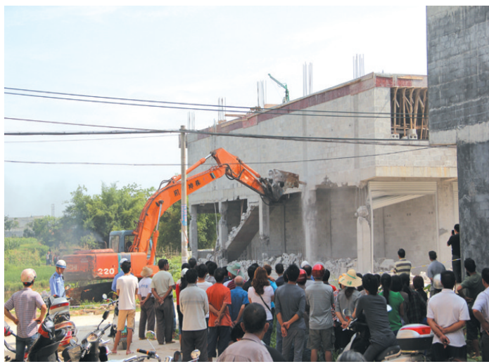
▲该县执法部门在城区附近的八仙开发区强行拆除“两违”楼房。(黄鹏欢 摄)
